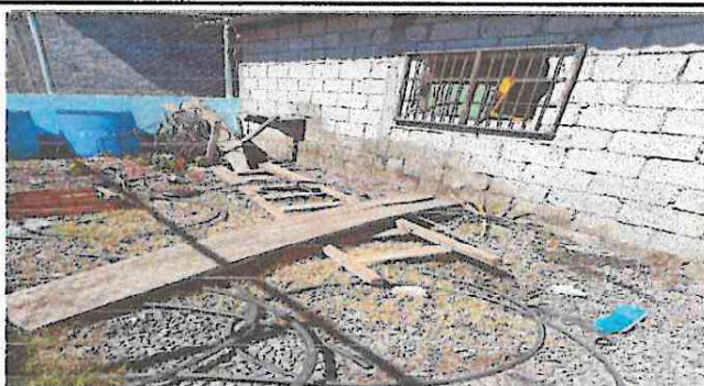
Foto 2: ES DE SUMA NECESIDAD LA SUSTITUCION DE BALCONES Y VENTANAS, POR SU DETERIORO YA QUE VIVIMOS EN UNA ZONA COSTERA CERCANA AL MAR.
