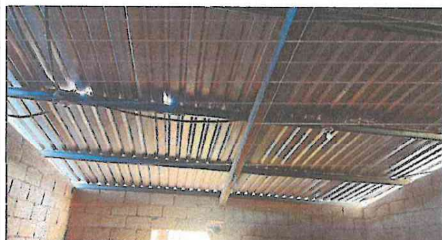
Foto 3: ES NECESARIA LA SUSTITUCION DEL TECHO POR QUE LA MAYORIA DE LAMINAS ESTAN EN SU TOTALIDAD CON DANOS GENERALES
