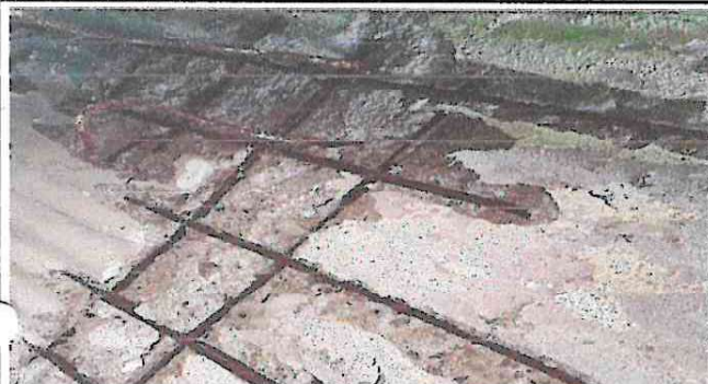
ES NECESARIO LA SUSTITUCION DEL PISO DE TORTA POR DETERIORO Y POR QUE SIGNIFICA PELIGRO Y MUCHO RIEGO POR LA VULNERABILIDAD A LOS NIÑOS Y NINAS.
