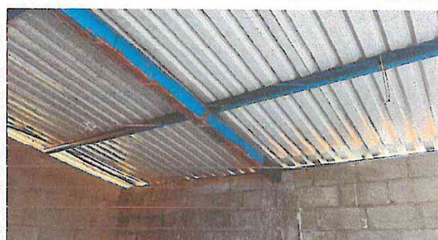
ES NECESARIO LA SUSTITUCION DE LA ESTRUCTURA DEL SOPORTE DEL TECHO POR SU DETERIORO Y TIEMPO QUE TIENEN
